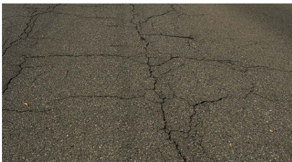
2-р зураг: Хүйтний үйлчлэлээр асфальтбетон хучилтад үүссэн эвдрэл
