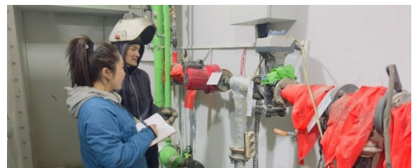
9-р зураг. Халаалтын системийн холигч насосыг өгөх шугам дээр суурилуулсан хэмжилт хийн үзүүлэлт цуглуулж буй байдал
