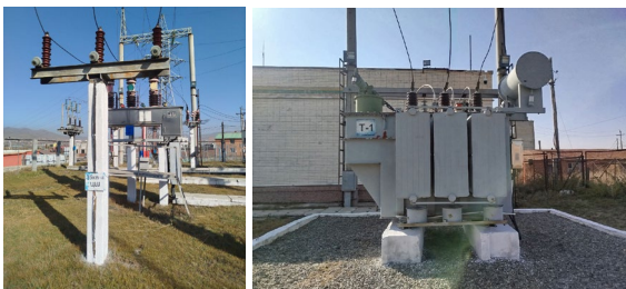
б) 35 кВ-ын ОПН болон трансформатор
